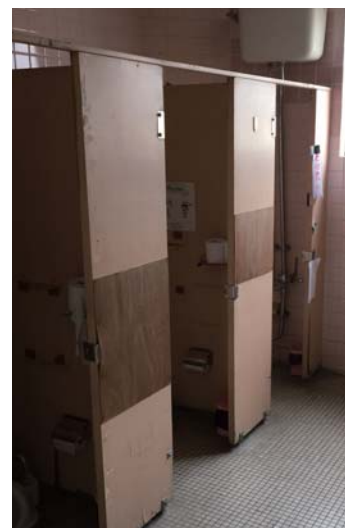
改修が待たれるトイレ
